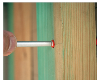
Gevelschroeven en pluggen door de regels en isolatie in de ondergrond plaatsen.
