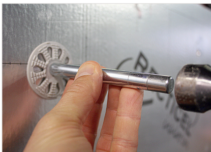
Spouwanker met behulp van inslagpijpe tot de gewenste diepte in de plug slaan.
