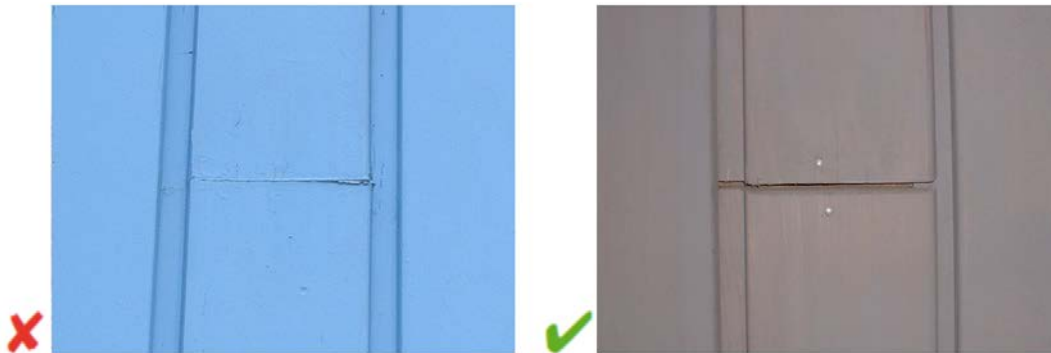
Afbeelding 8 - Stuiknaden fout gemonteerd (Bron: Centrum Hout, 2024)
