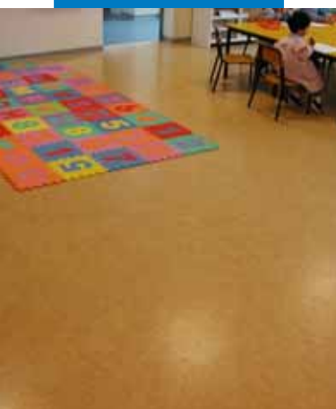
Linoleum aangebracht op een met Ultraplan Eco geëgaliseerde dekvloer - Kleuterschool Mirabello - Cantù (Como) - Italië
